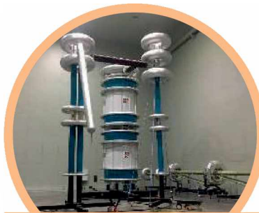
Испытательная станция Highvolt до 750 кВ
